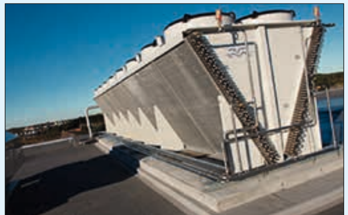
Ammoniakk-anlegget hos FMC Technologies har en luft-vann varmeveksler på taket, med 2214 m 2 coil-areal.
