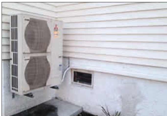
Luft til vann varmepumper er et alternativ til oljefyr i hus med radiatorer for vannbåren varme.
