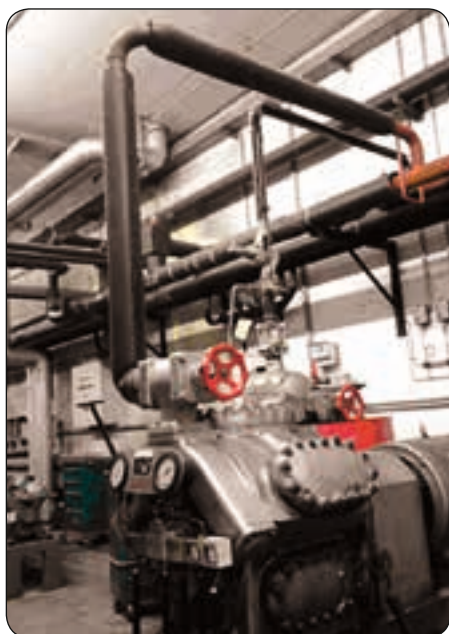
Billed af anlægget inden sensorene blev monteret.
