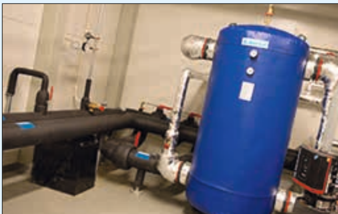
Overskuddsvarme fra toppkjøling av kompressor akkumuleres på en 1000-literstank med glykol. Det brukes til å avrime utedelen når varmepumpa kjøres i varmedrift. Da går den i totrinns kompresjon, mens den går i ett trinns kompresjon i kjøledrift.
